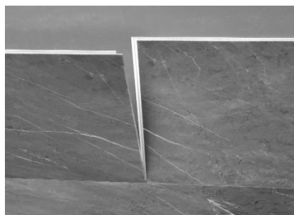
Colocar la siguiente pieza igual que la anterior y llevar justo sobre el lado corto de la tabla ya colocada
